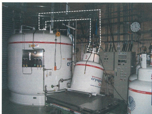
図1 傾いた250リットル容器と曲がった移送管。
