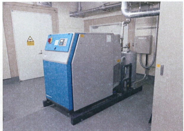
図3：バウアー社製ヘリウムコンプレッサー
