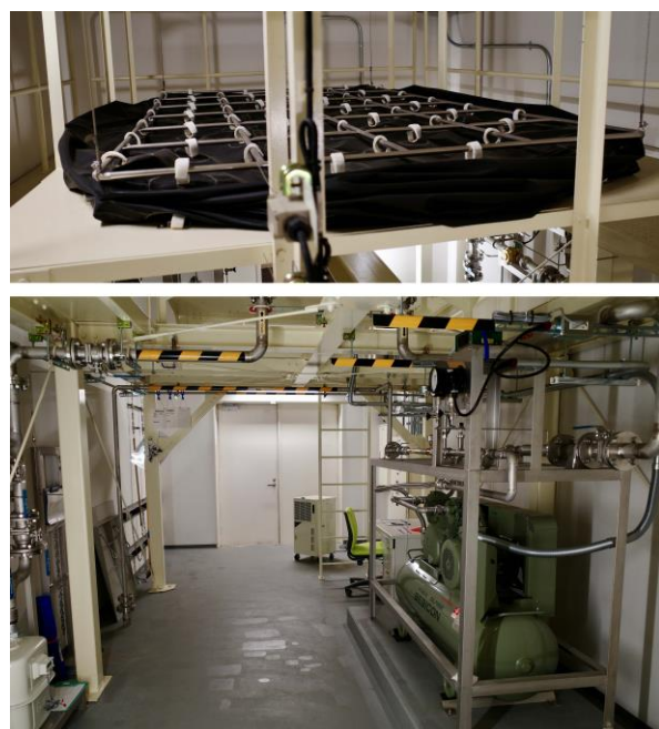
図3. 電気通信研究所本館ヘリウム回収設備。2014年完成。
