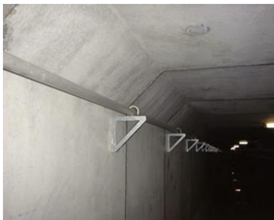
共同溝内のヘリウムガス回収配管
