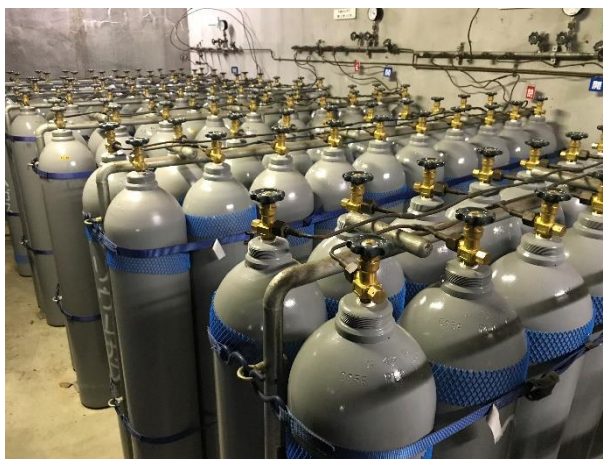
図5 回収ガスボンベ群
