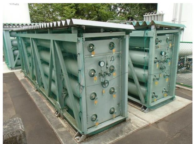
図4 増設した長尺ガスカードル群
