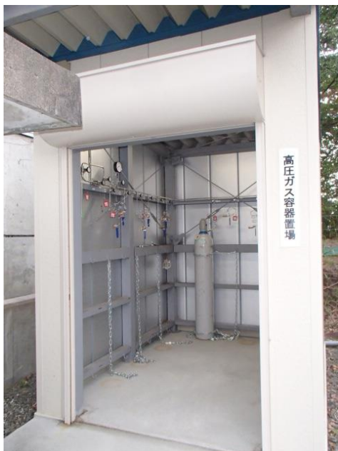
図4 新設したヘリウムガスボンベ庫
