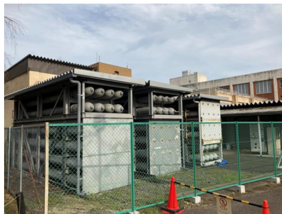
図 6 増設された回収ヘリウムガス長尺カードル群
